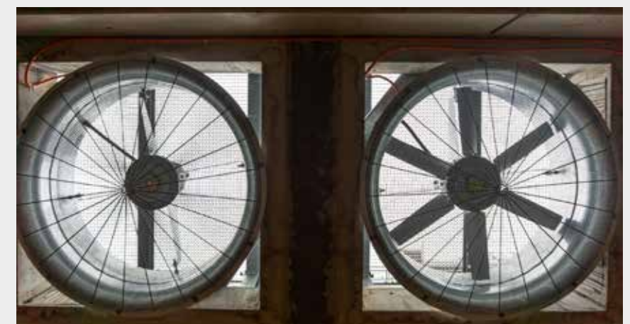
Inductieventilatoren parkeergarage Lucentterrein.
