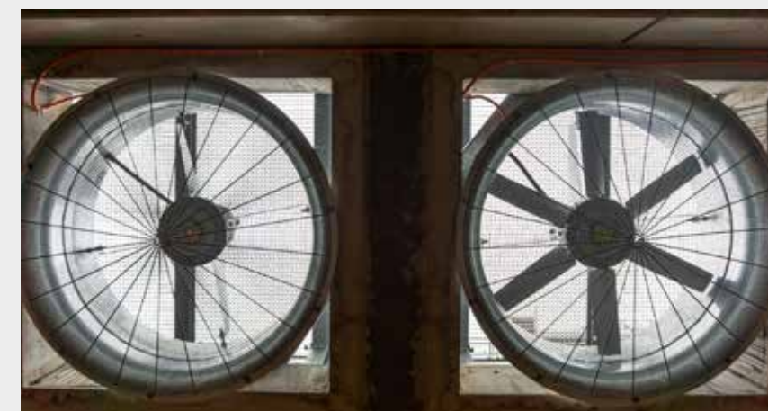
Inductieventilatoren parkeergarage Lucentterrein.
