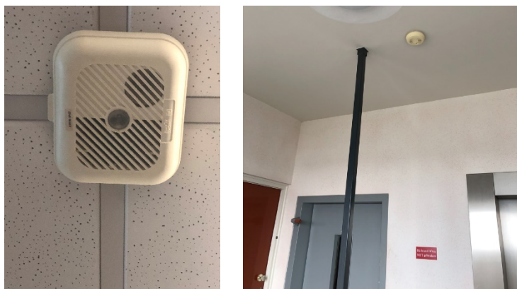
Figuur 5.1 Rookmelders in de vluchtroute
